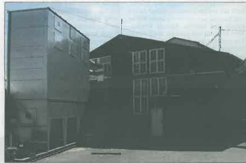
Filter der Absaugung des Hobelwerkes
